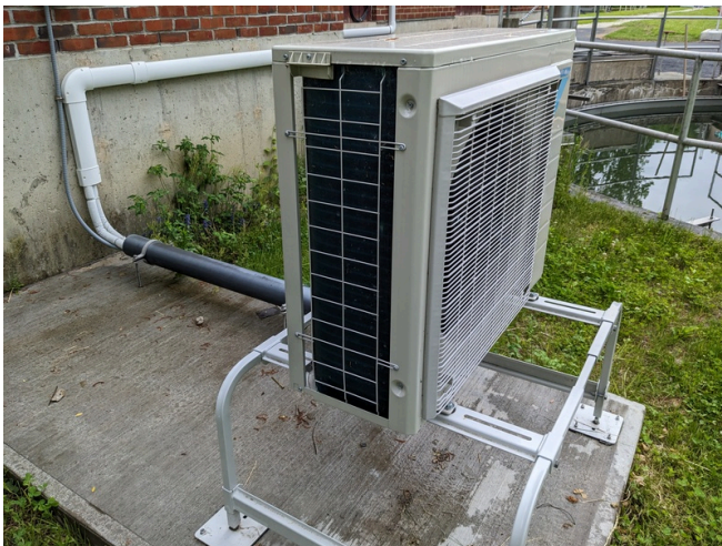
ASPH Mini Split Condenser
