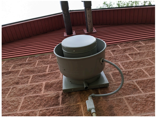
B3 South Wall Exhaust Fan
