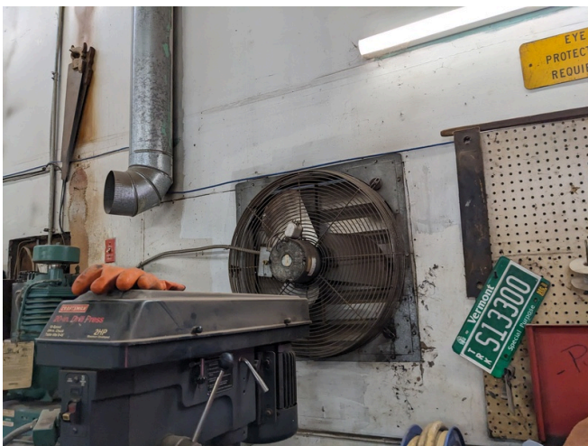
New - Garage Exhaust Fan
